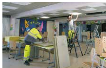
Les restaurants scolaires de C. Chausson, Joliot-Curie et Virevialle ont été équipés d'éclairage LED.
