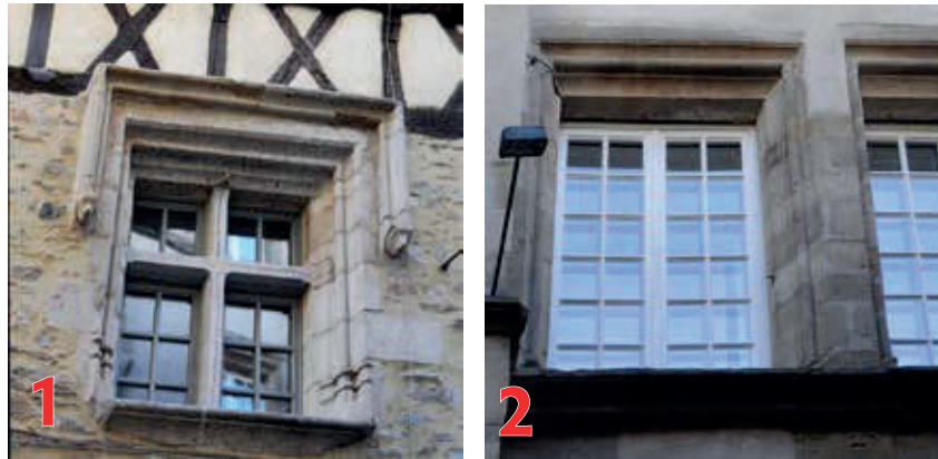
Cas n°1 : restitution incomplète, mais qui laisse voir l'arrachement des parties disparues.
